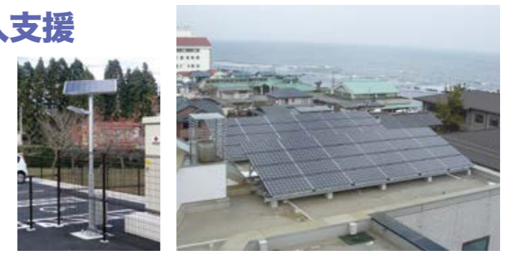
保育所に設置した太陽光発電設備(野田村)
