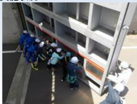
陸閘の開閉操作体験状況 (R1. 5. 20)
