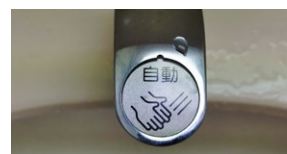
手をかざすことで水が出る自動水栓
