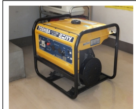
発災直後、非常用電源装置のない庁舎・建物では、可搬式発電機も多く使用された。
