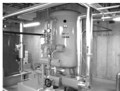
雨水貯留施設（二戸地区合同庁舎）
