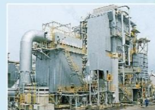
バイオマスボイラーの燃料として再利用されています。
