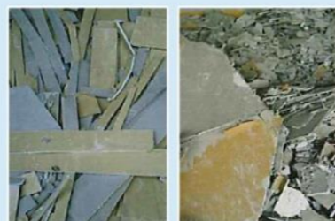
石膏ボード廃材。
