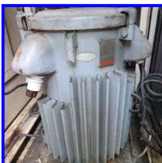
トランス (変圧器)
