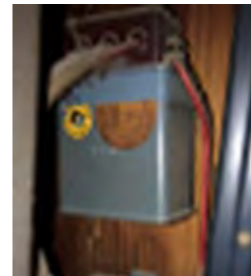
分電盤に設置された 低圧コンデンサー
