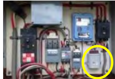
低圧分電盤内の低圧コンデンサー
