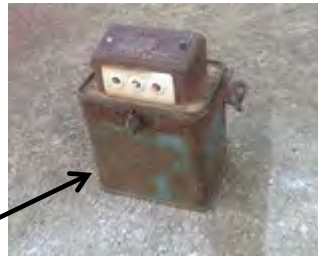
揚水ポンプの分電盤 に設置されていた 低圧コンデンサー
