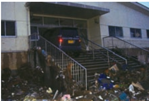
陸前高田市立高田小学校の体育館(平成23年3月11日) 陸前高田市教育委員会提供
