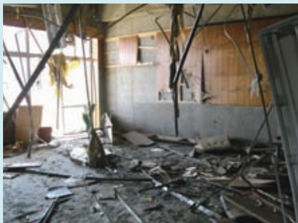
震災後の校舎内の様子
