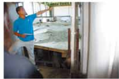
津波に破壊された体育館
