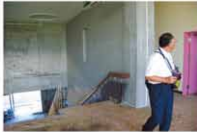
津波により手すりの取れた階段
