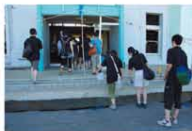
地盤沈下により地面と離れた玄関
