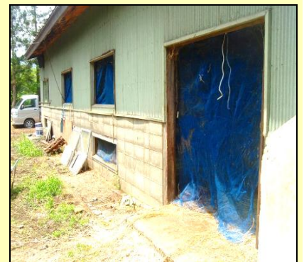
防虫ネットを設置した牛舎（例）
