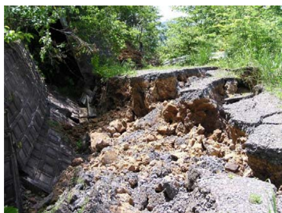
平成20年岩手・宮城内陸地震災害 (一関市巖美町 猪岡線)
