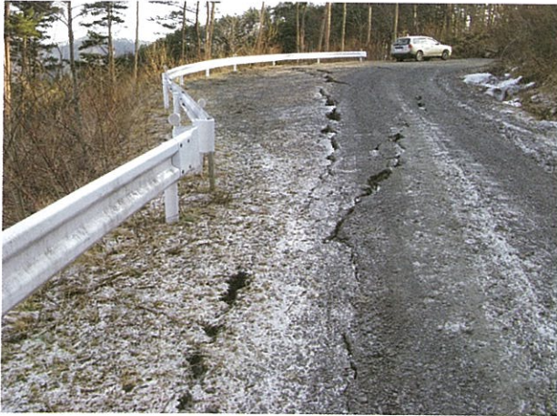
(写真一) 五本松峠線の被害状況
