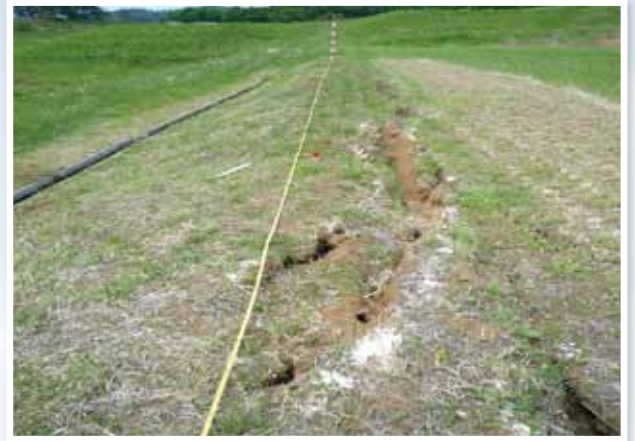
花巻市東和町(水田の法面崩壊)
