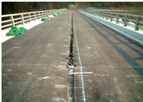
奥州市衣川区(防災ダム天端(管理道路)の亀裂)
