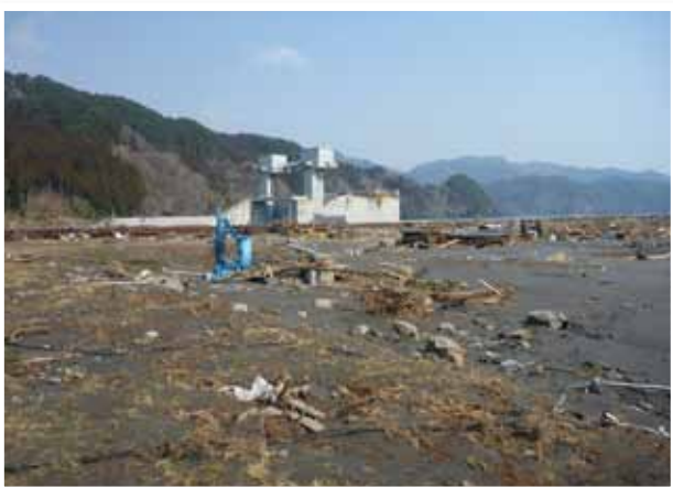
海岸堤防及び背後農地の被災状況 平成23年3月
