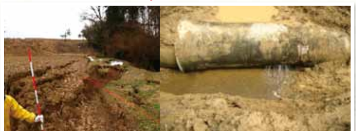
一関市花泉町(幹線パイプラインの破損)
