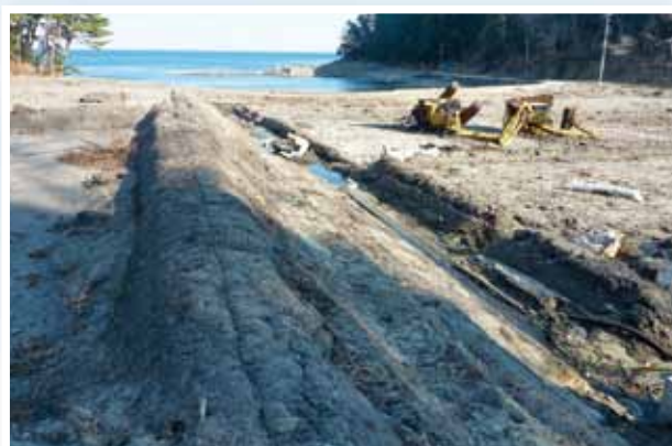
被災状況 平成23年3月
