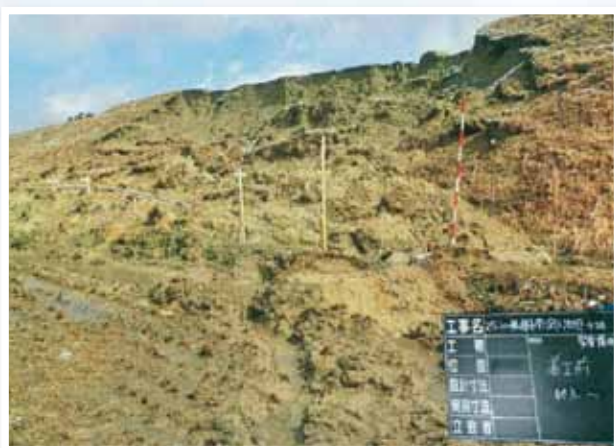
法面崩落による用水路の閉塞
