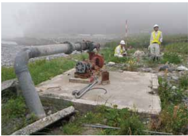
建屋、電気設備等が被災
