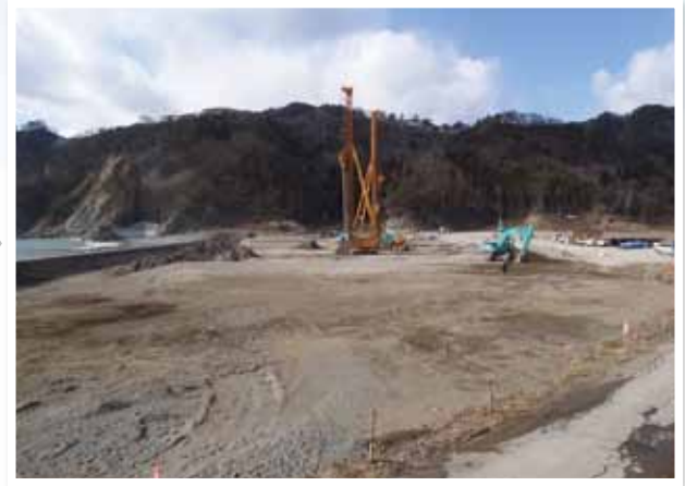
グラベルコンパクションパイルによる 地盤改良工事中 平成26年1月
