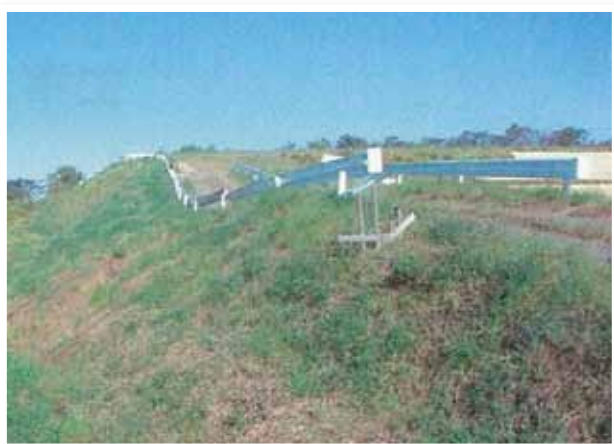
農道の法面崩落
