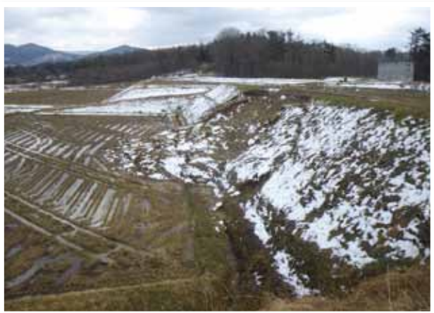
法面の崩壊と水路の破損
