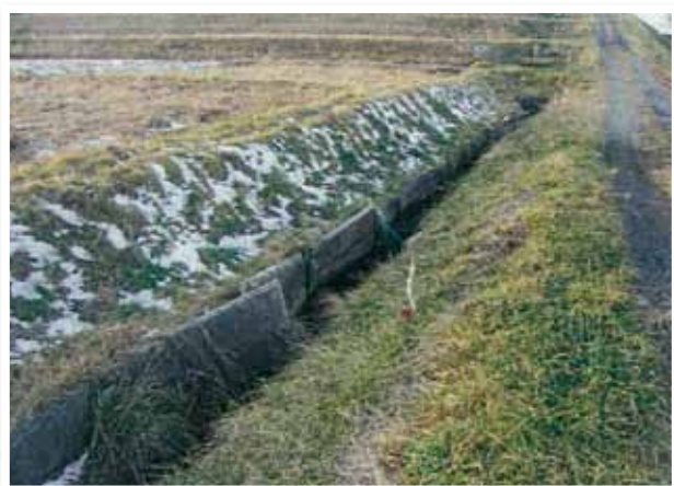
排水路の崩壊
