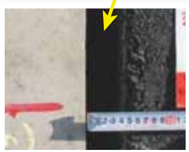
詳細① 下流側地覆の開き
