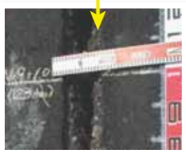
詳細② 舗装面の開き
