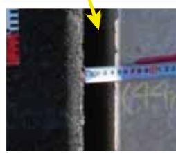
詳細③ 上流側地覆の開き
