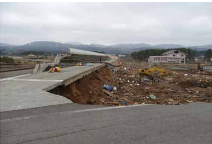
被災の状況 (平成23年3月15日)
