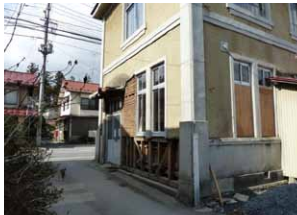
被災した金流川沿岸涌津土地改良区
