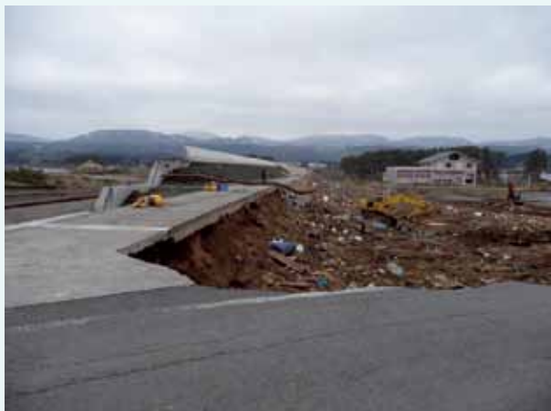
野田農地海岸堤防の被災状況
