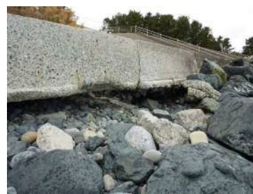
防潮堤と捨石の被災状況
