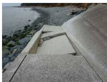
防潮堤の被災状況
