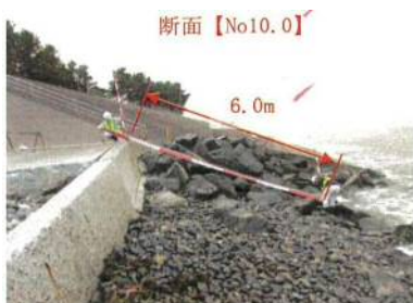
捨石の被災状況
