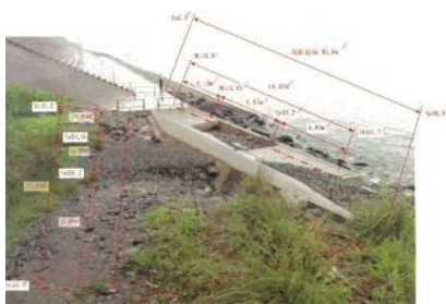
防潮堤の被災状況
