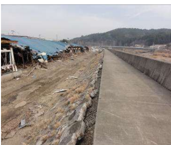
被災後状況 (左岸堤内側)
