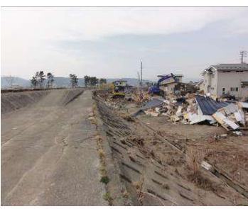
被災後状況 (左岸堤内側)
