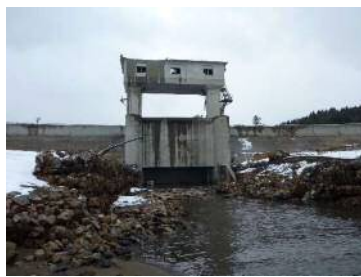
米田水門の被災状況
