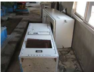
米田水門内部の被災状況
