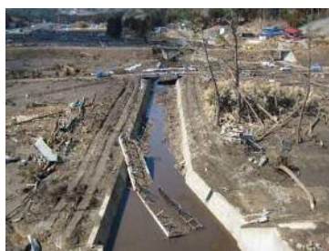
水門上流部の被災状況
