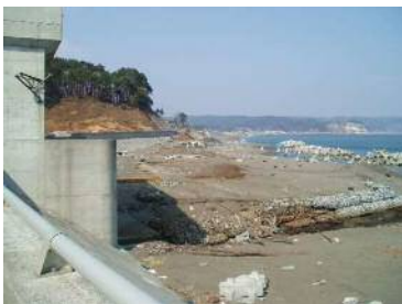
砂浜の被災状況
