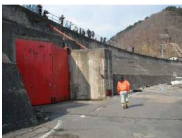
陸間の被災状況
