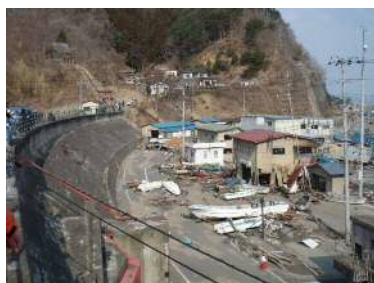
防潮堤前面の被災状況
