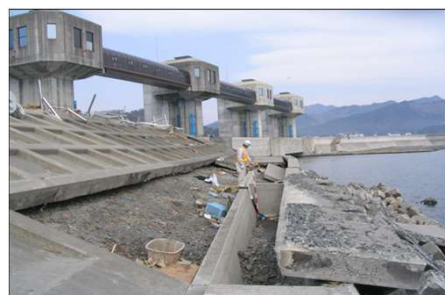
小鍬川水門被災状況②
