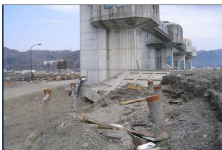
小鍬川水門被災状況①
