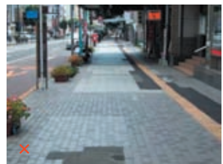
○アスファルトによる補修部分が景観を損ねている。
