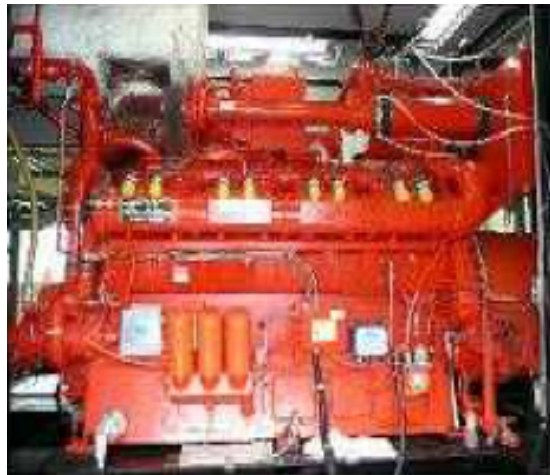
都南浄化センター560kw ガスエンジン
