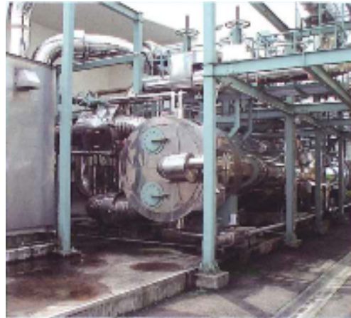
中川ポンプ場にある下水熱回収施設
