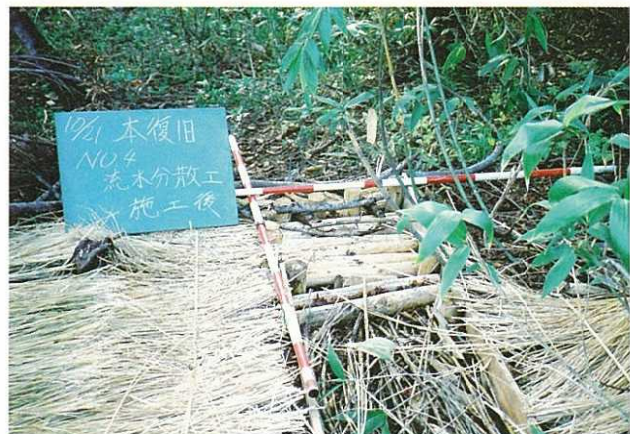
写真3-16 本復旧対策における流水分散工 (上：施行前，中：施行中，下：施行後)
