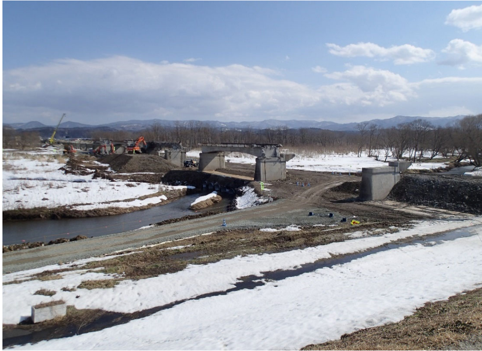
令和4年2月 小谷木橋上部工（RCゲルバー桁）の取壊し撤去
