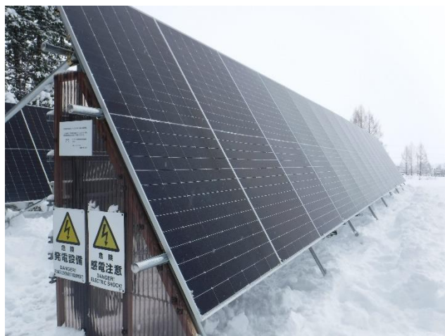
ラ・フランス温泉館太陽光発電設備導入事業(紫波町)
