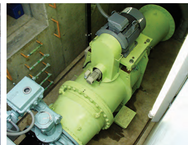
北ノ又第三発電所 水車発電機
