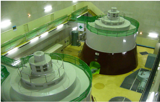
岩洞第一発電所(地下発電所)
