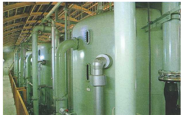
急速ろ過施設（半導体工場用高純度の水を精製）
