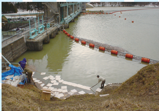
重油流出事故発生時の回収作業 (平成17年4月重油8,000ℓが流出したため、上水道と工業用水道の供給が停止しました)
