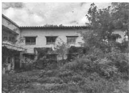
雑草や樹木が生い茂って 建物を覆っている例
