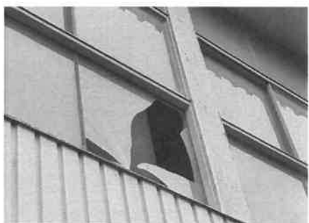
窓ガラスが割れている例
