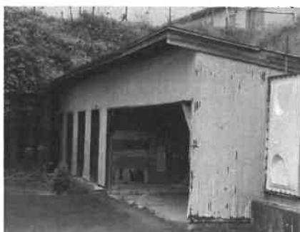
建物（物置）の戸が開いた ままとなっている例
