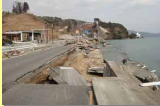
海岸線の国道45号は各地で寸断(山田町)
