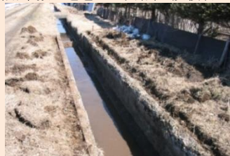
【耐用年数を超過した水路(建設後約50年)】
