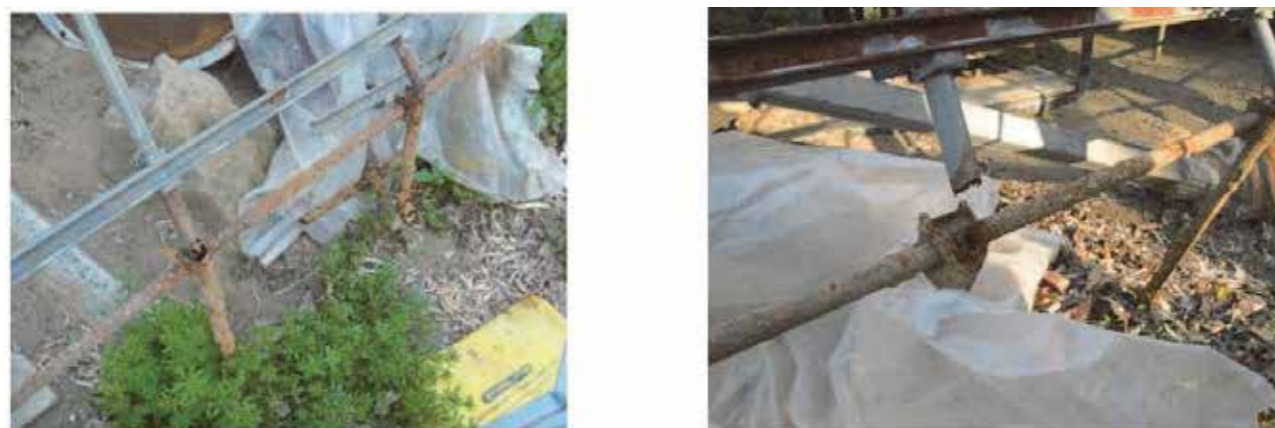
地際部の腐食による折れ
