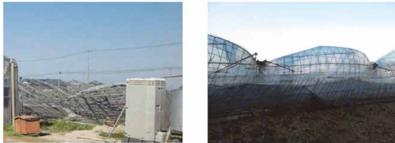
積雪と強風により横倒しに倒壊した事例
