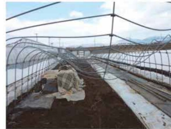
単棟パイプハウスのM字型陥没
