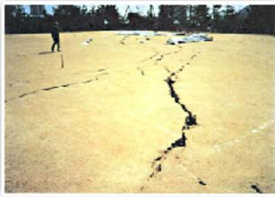
幅が15cm以上と変状の程度が大きいクラック(ひび割れ)
