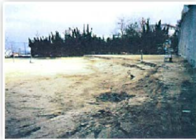
沈下量が50cm以上と、変状の程度が大きい地盤
