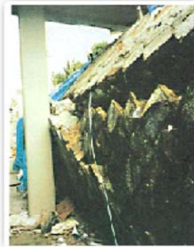
基礎部を含めて完全に機能を失っている擁壁
