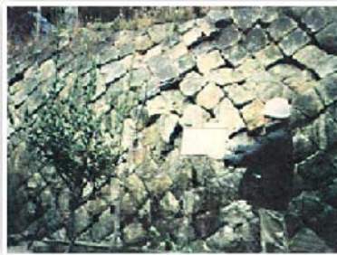
致命的な被害を受け、その機能を失っている擁壁(写真には写っていないが、宅盤にテンションクラックがあり、円弧すべりのおそれがある)
