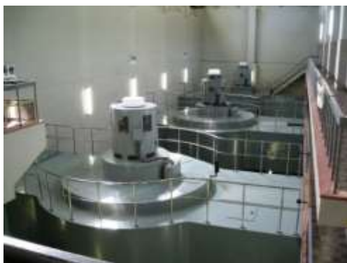
仙人発電所（奥側 2機が仙人発電所）
