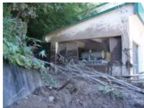
H25 台風 18 号による北ノ又発電所の被害
