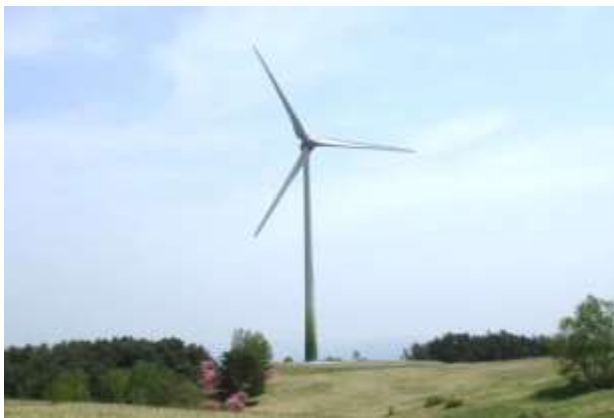
高森高原風力発電所
