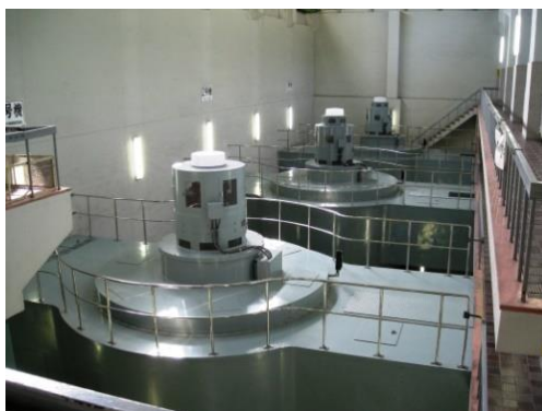
仙人発電所（奥側 2機が仙人発電所）
