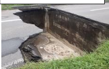
被災直後【県道角ノ浜玉川線】
