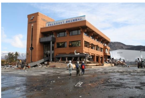
東日本大震災津波により被災した 大船渡商工会議所会館
