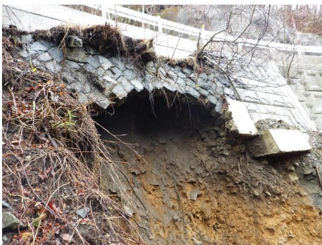
崩落状況(R2年4月時点)
