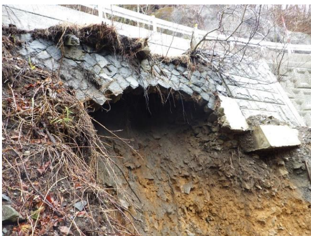
崩落状況(R2年4月時点)
