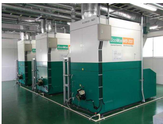
【いわて型チップボイラー】
