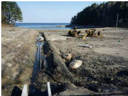
被災状況_岩倉工区 (H23.3)
