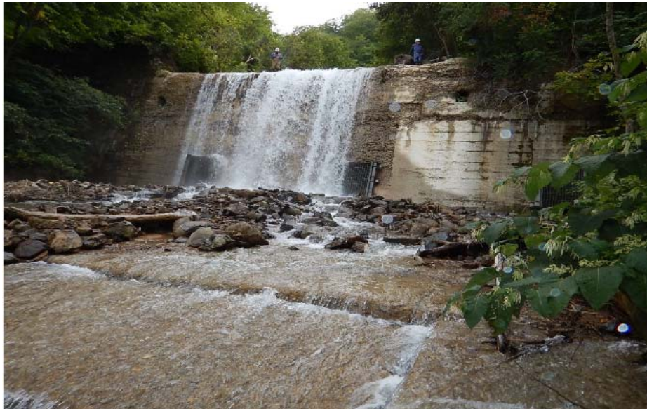
図 11 砂防設備の損傷状況（事例）
