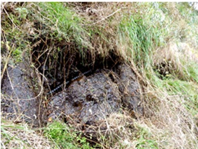
湧水による法枠工の安定性低下
