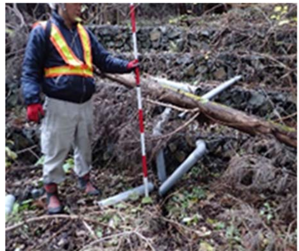
横ボーリング工の損傷
