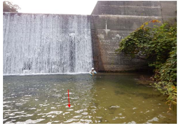
堤体基礎の洗堀
