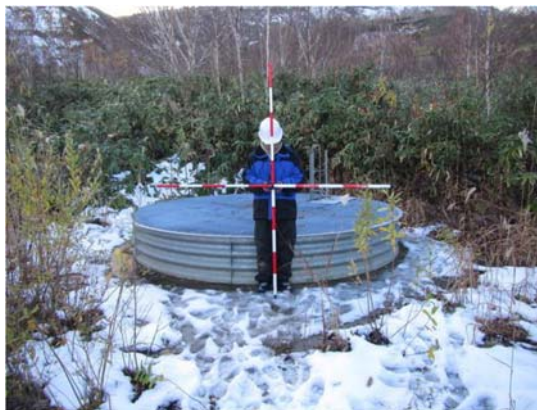
図 3 地すべり防止施設（集水井工）
