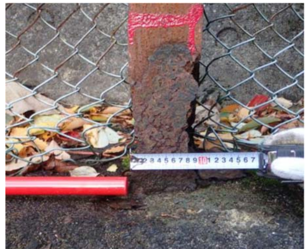
落石防護柵の支柱腐食
