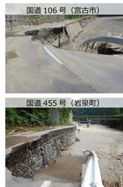
図 3-14 平成28年台風第10号による被害状況
