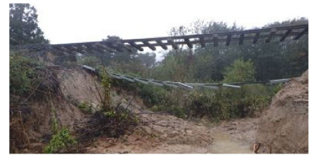
土砂が流出した三陸鉄道（山田町）
