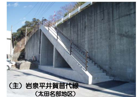
▲避難に活用可能な階段の設置例
