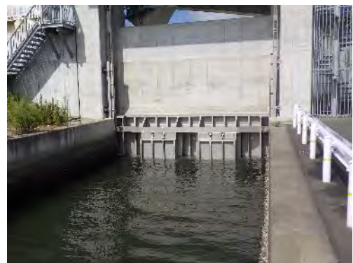
須賀水門 閉鎖の様子
