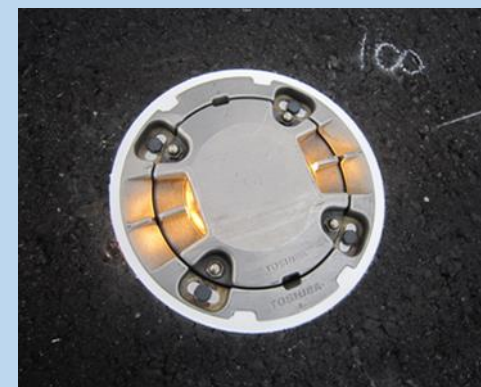
※ 灯器の点灯状況
