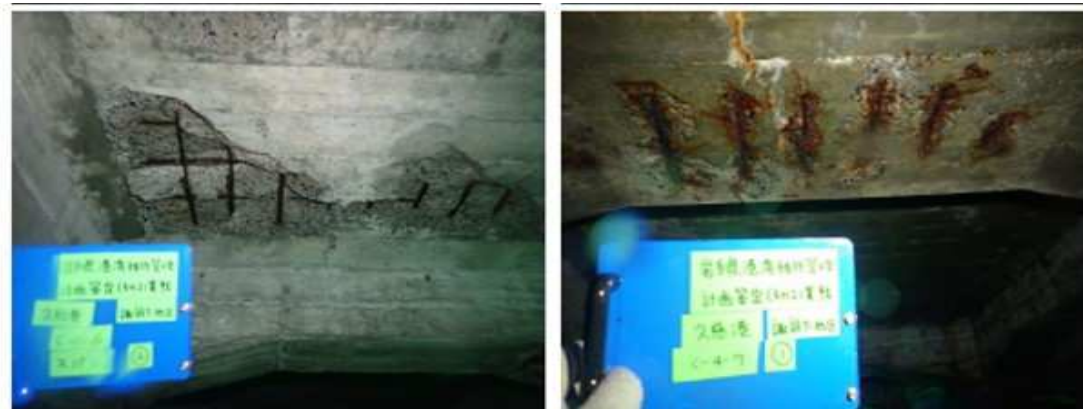
港湾施設の損傷事例
