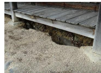
写真：文化財被害の状況
