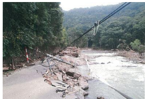
写真:平成28年台風第10号による道路被害の状況(岩手県岩泉町)
