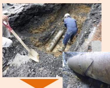
【パイプラインの突発事故への対応状況】
