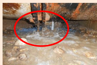
【パイプラインの突発事故による破損・漏水】
