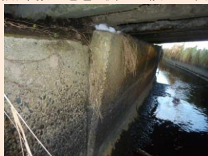
【耐用年数を超過し側壁が傾いた水路】
